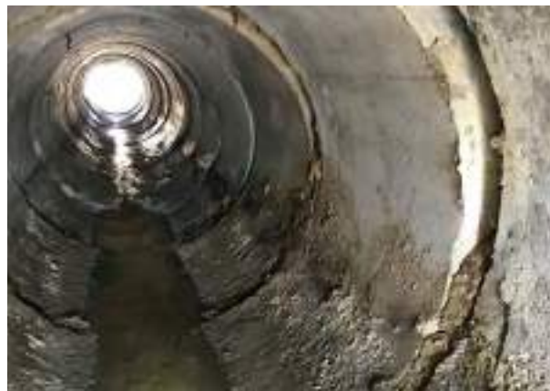
Разрушение межзвеньевых швов
