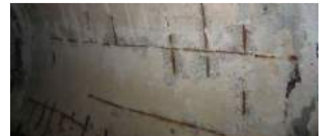
Оголение и коррозия арматуры
