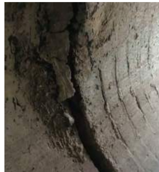
Разрушение межзвеньевых швов
