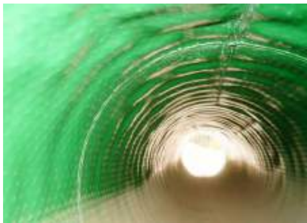
Неравномерная ребристая поверхность трубы
