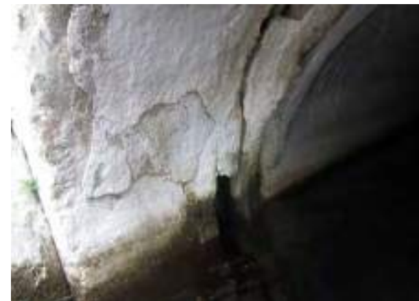
Разрушение шва вследствие выпучивания крайней секции
